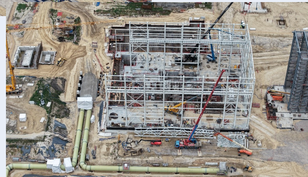
Maszynownia z fundamentem Turbozespołu i rurociągami GRP wody chłodzącej
