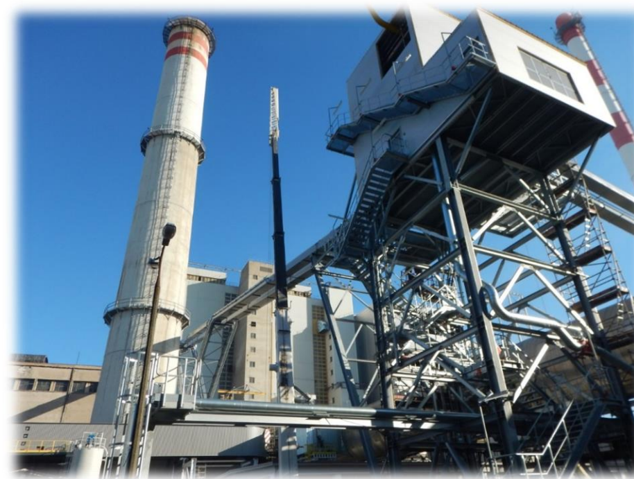
Nowa wieża przesypowa i rurociągi podawania biomasy
