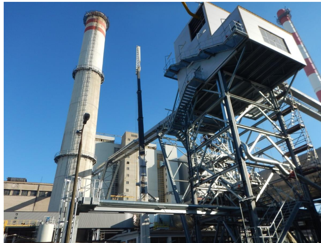
Nowa wieża przesypowa i rurociągi podawania biomasy
