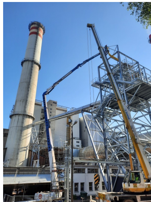
Nowe obiekty układu podawania biomasy do kotła K7 – wieża przesypowa i rurociąg podawania biomasy do kotła.
