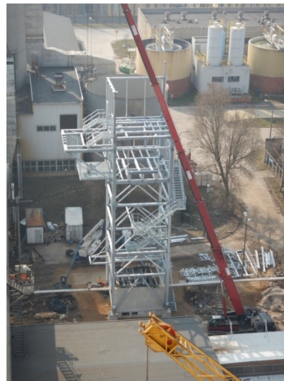
Nowa wieża przesypowa układu podawania biomasy do kotła K7
